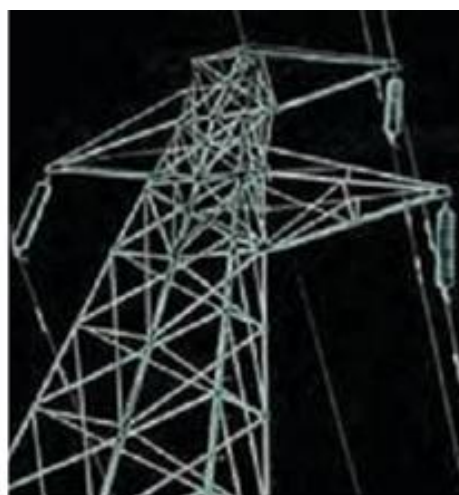
دکل انتقال برق
